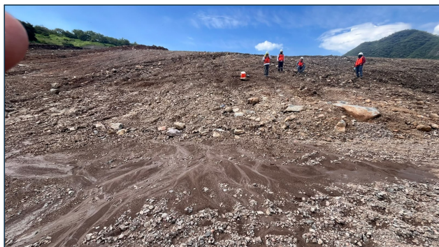
1. Recorrido de inspección — identificación de la zona con material saturado.
