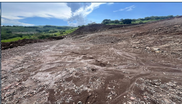
2. Material saturado identificado en la superficie del relleno.
